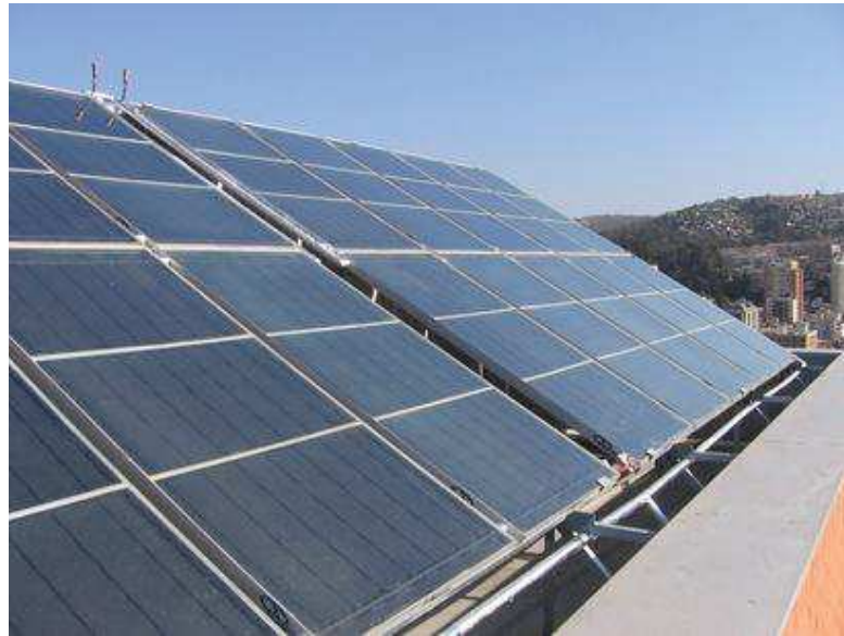
Figura 2. Paneles Solares Fotovoltaicos
