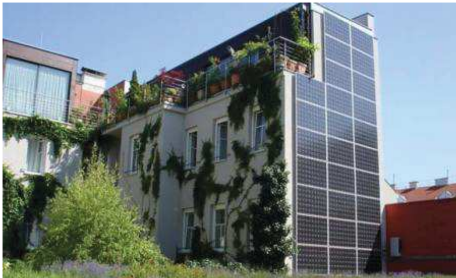
Figura 16. Instalación fotovoltaica y térmica al costado de la edificación
