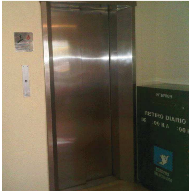
Figura 28. Circulacion vertical - ascensor.
