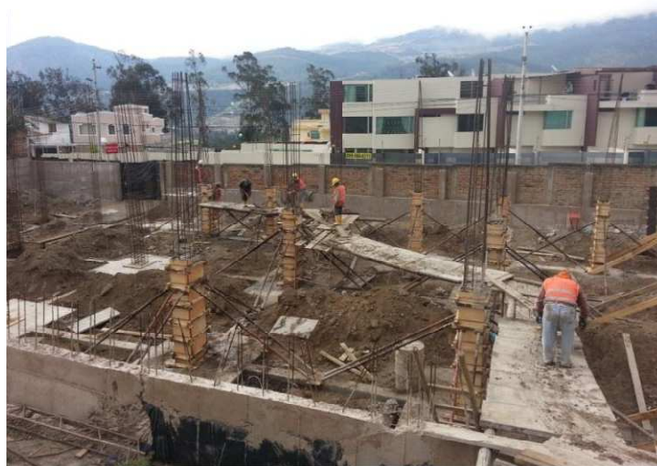
Figura 8: Espacios de trabajo para fundición manual de columnas Tomado de: Castillo&Cadena Constructora (2013)
