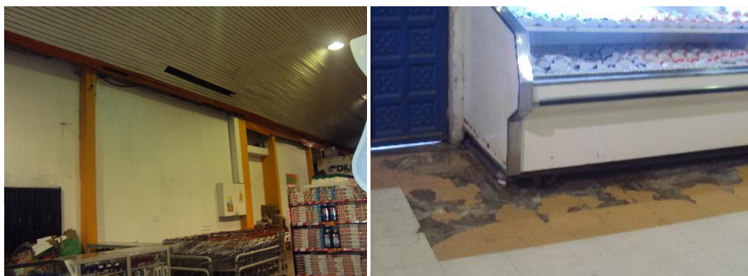
FIGURA 88-89. ESTADO ACTUAL DE CUBIERTA Y PISO.
