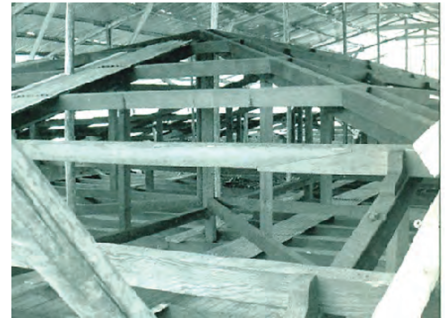
Figura 78. Estructura del bloque administrativo de la Estación actualmente en reparación. Tomado de Pino, 2008.
