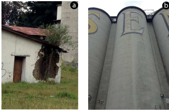
Figura 89. Imágenes de incumplimientos de parámetros
