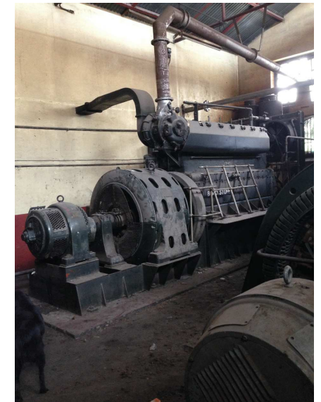
Figura 27. Cuarto de máquinas.
