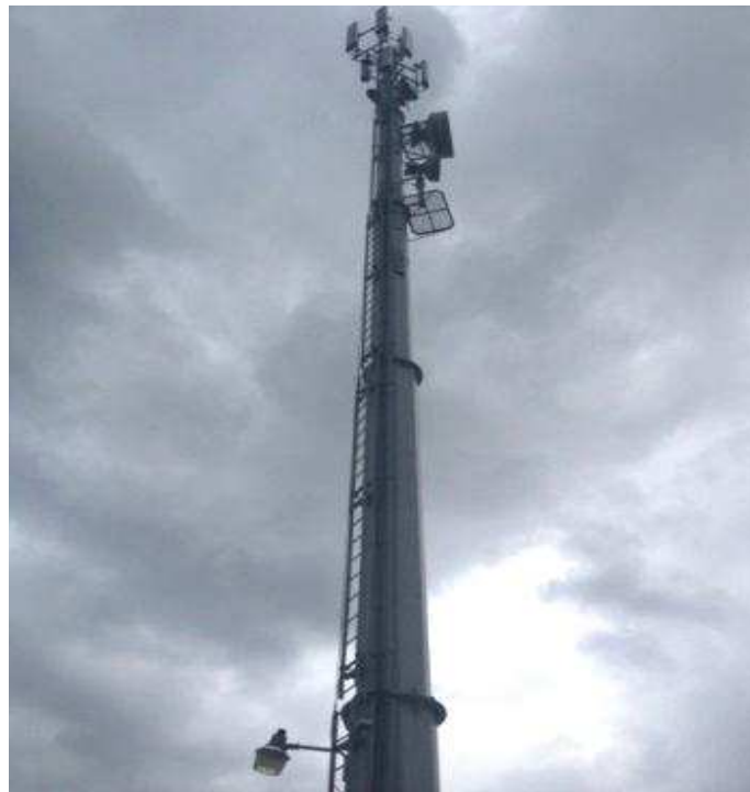
Figura 13. Torre tipo monopolo.
