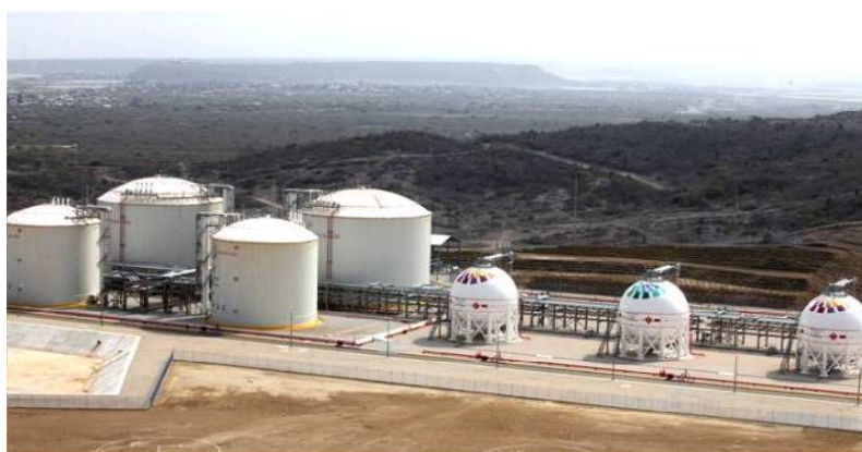
Figura 15. Planta de almacenamiento de GLP (Monteverde - Santa Elena)
