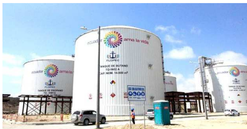
Figura 17. Tanques de butano y propano (Planta de Almacenamiento Monteverde)
