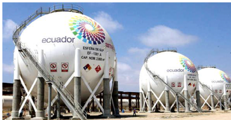
Figura 16. Esferas de GLP (Planta de Almacenamiento Monteverde)
