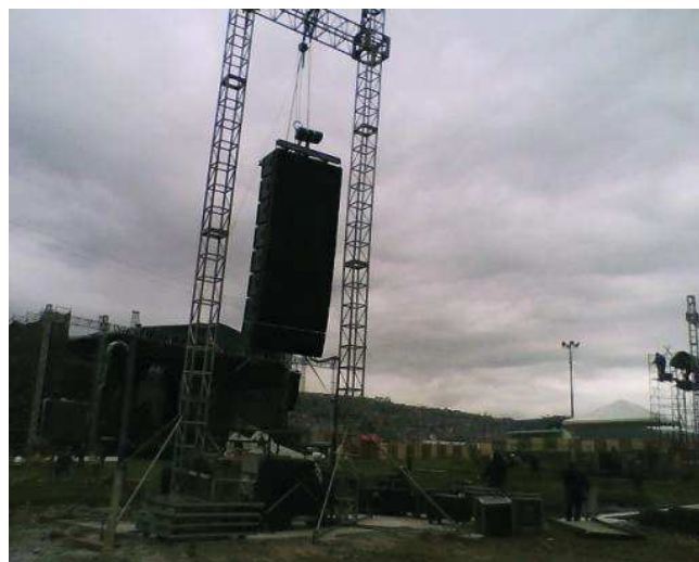
Figura 4.18. Torre de delay a 55 metros del escenario.
