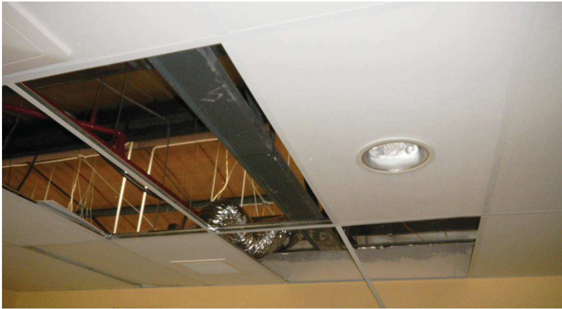
Figura 49. Techo flotante originalmente instalado en sala de proyección.
