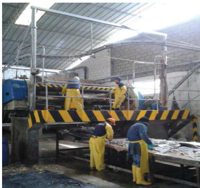
Figura 44. Implementación realizada en el área de descarnado a) Como medida de corrección se realizó la implementación de una baranda de seguridad, la cual servirá de protección para que no ocurran eventos futuros.
