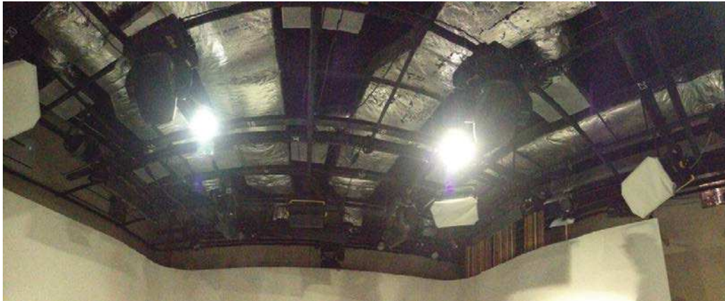
Figura. 37 Ductos de ventilación
