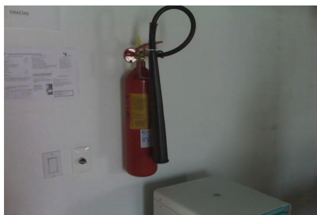
Figura 3.1 Extintor laboratorio Biología
