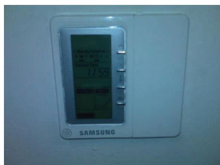
Control manual aire acondicionado
