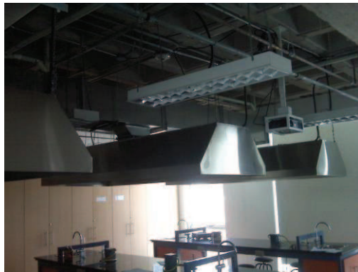
Extractor de humo laboratorio biología
