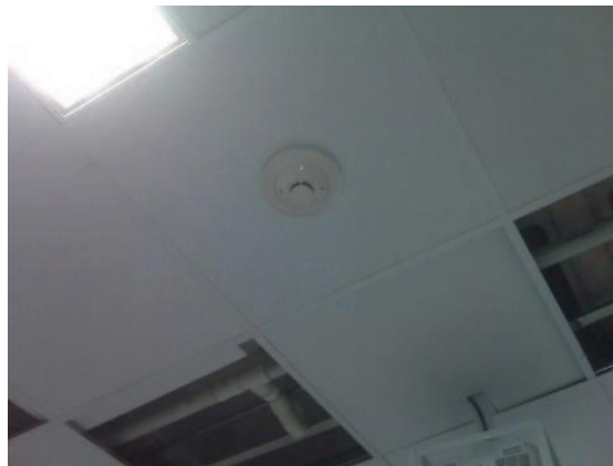
Figura 3.28 Detector de humo laboratorio Física y Metrología
