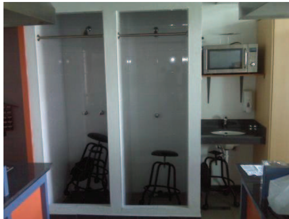
Figura 3.20 Duchas de emergencia laboratorio Microbiología
