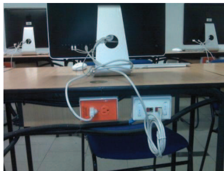
Figura 3.49 Tomacorriente laboratorio MAC
