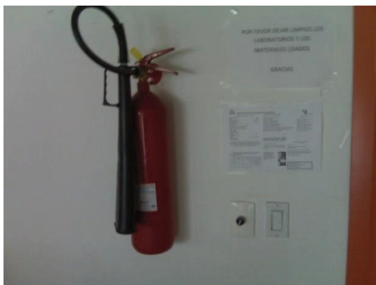
Figura 3.11 Extintor laboratorio Química
