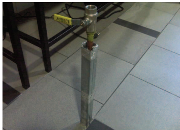
Figura 3.39 Señalización incorrecta tubería Parasitología e Histología
