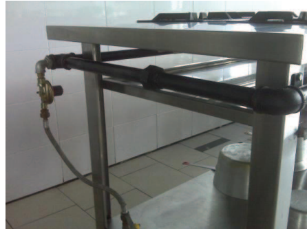
Tuberías de gas taller de cocina Caliente
