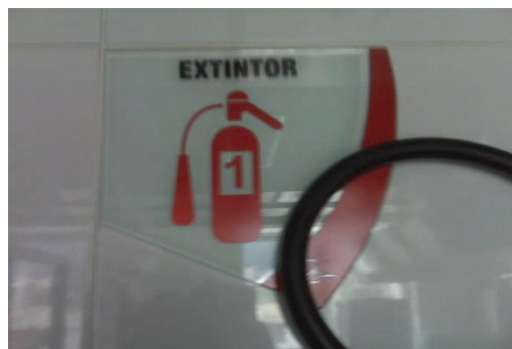
Figura 3.41 Letrero extintor Taller de Cocina Caliente
