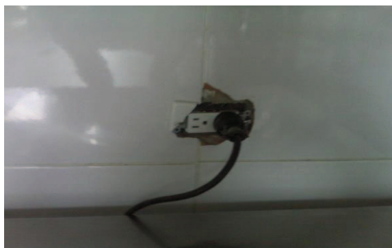
Figura 3.45 Tomacorriente defectuoso Taller de Cocina Caliente
