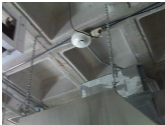
Figura 3.13 Instalación incorrecta laboratorio Química
