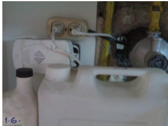
Figura 3.12 Instalación incorrecta laboratorio Química
