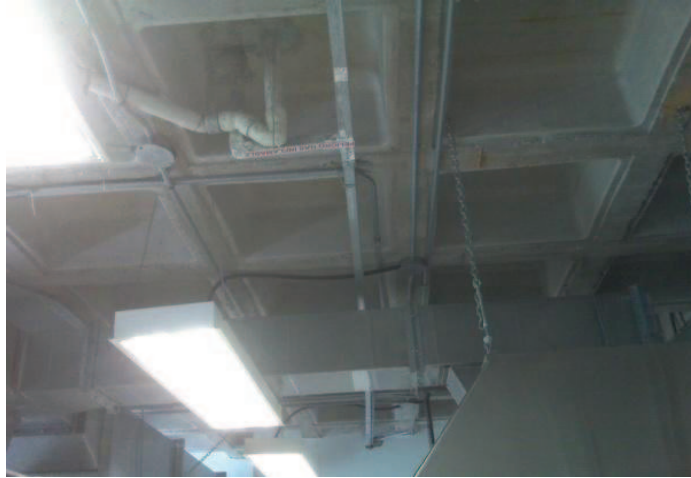
Figura 3.14 Tuberías laboratorio Química
