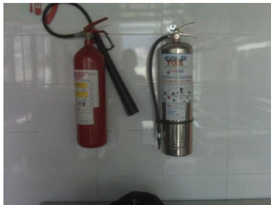
Figura 3.40 Extintores Taller de Cocina Caliente
