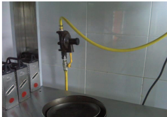
Figura 3.44 Señalización de seguridad Taller de Cocina Caliente
