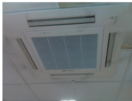
Aire acondicionado laboratorio Electrónica
