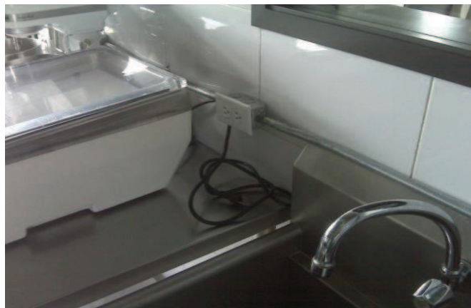
Figura 3.46 Tomacorriente mal instalado Taller de Cocina Caliente
