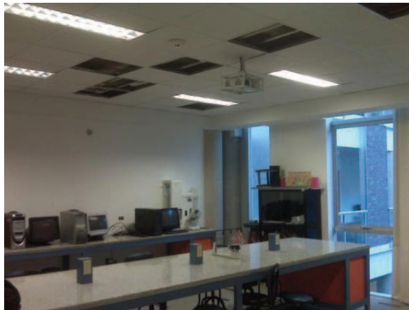
Figura 3.24 Iluminación laboratorio Física y Metrología
