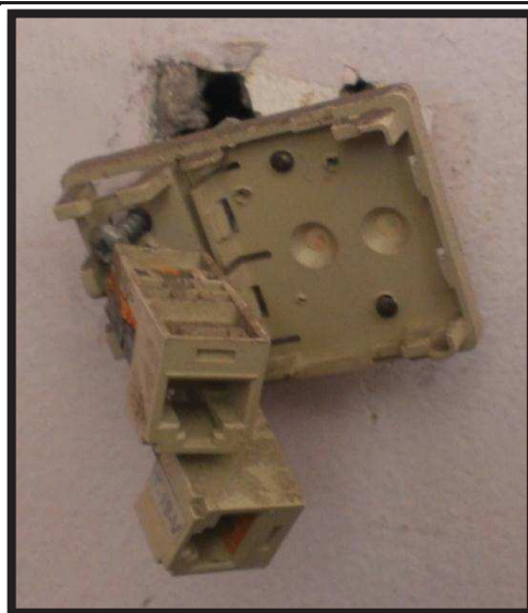
Figura 35: Cableado de datos punto de red oficina Director
