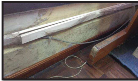
Figura 43: Cableado secretaria de grados.
