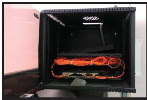
Figura 30: Gabinete con Switch de distribución de la ESFOT
