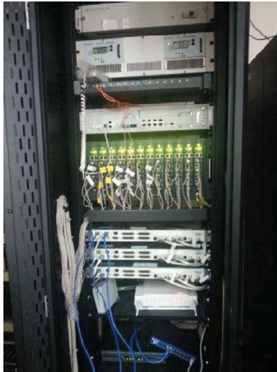
Figura 61. Rack de conexiones para Redes Microonda y fibra TE.
