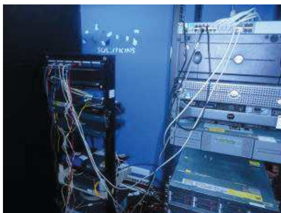
Figura 1 Data center actual
