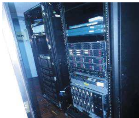
Figura 54 Data center hermetizado
