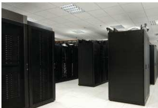
Figura 86 Cuarto de equipos o data center
