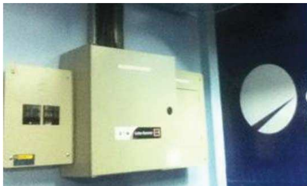
Figura 45 Tablero de distribución
