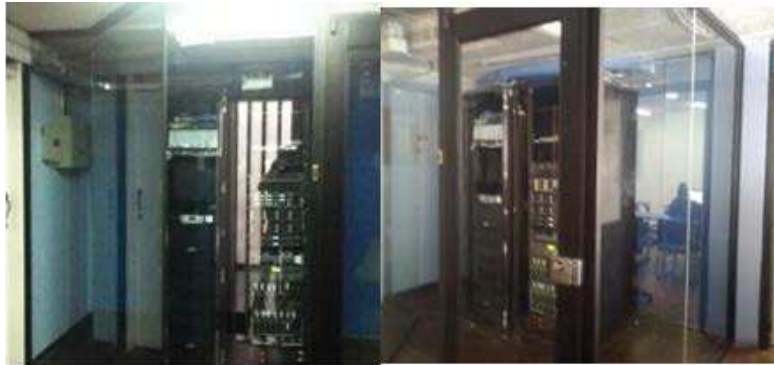
Figura 42 Nuevo Data center (vista frontal y lateral)
