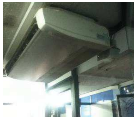
Figura 53 Data center actual, sistema de refrigeración LG
