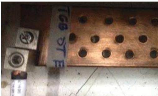
Figura 55 Toma a tierra
