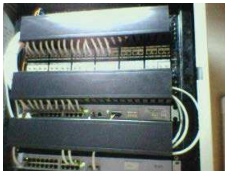
Figura 87 Armario de distribución
