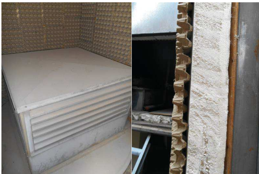
Figura 9. Izq. Ejemplo control de ruido - medidas empíricas instaladas en centro comercial de Quito
