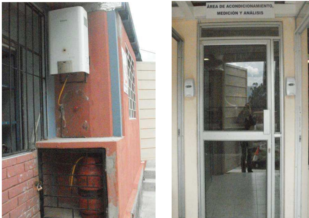
Fotografía 5.24 Instalaciones de gas y doble puerta
