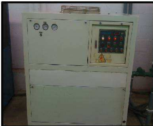
Gráfico 3.12: Chiller enfriador de agua.
