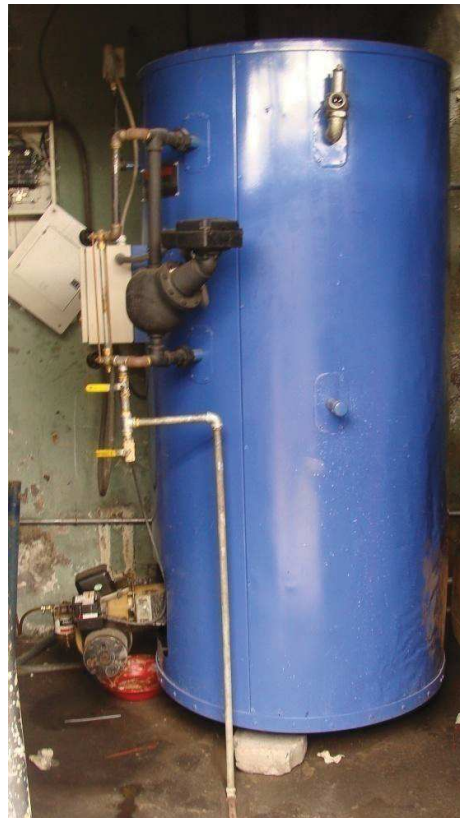
Figura 3.7: Ejemplo de un caldero a diesel
