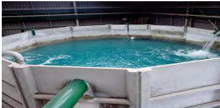
Figura 64. Planta de tratamiento de aguas
