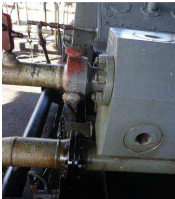
Figura 33. Liqueo en juntas flojas debido a la vibración del sistema.
