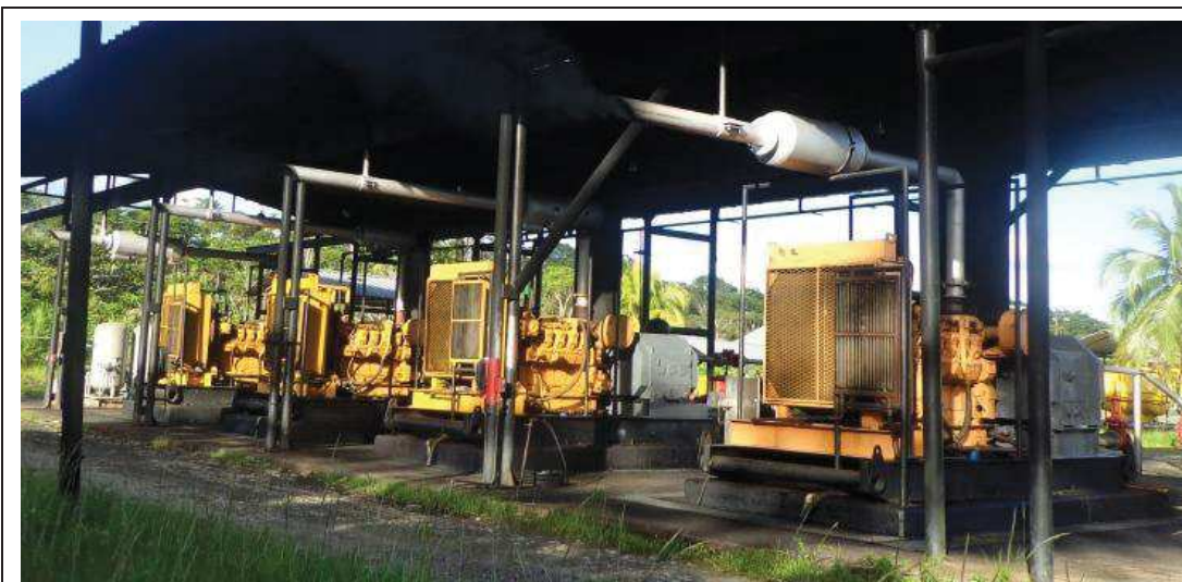
Figura 19. Bombas principales del sistema de Power Oil
