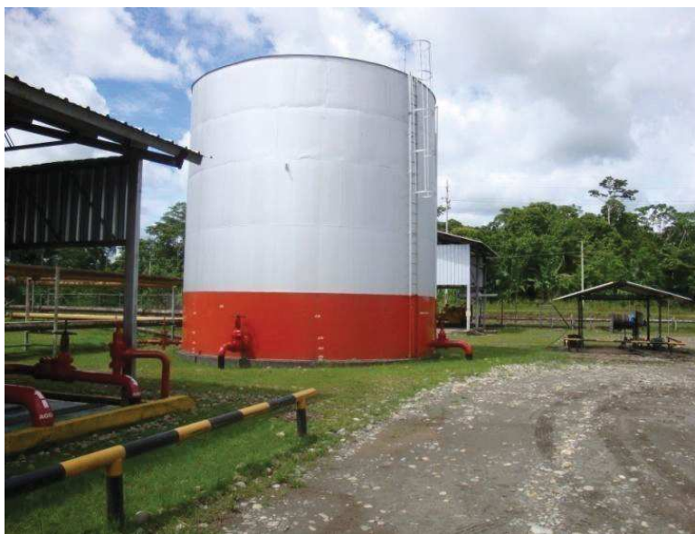
Figura 26. Tanque de almacenamiento de agua del sistema contra incendios.
