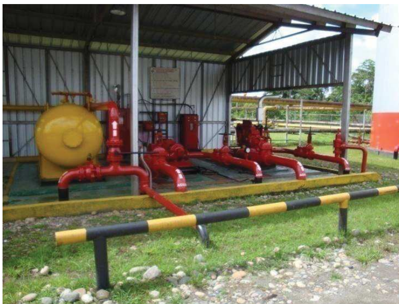
Figura 27. Bombas del Sistema contra incendios de la Estación
