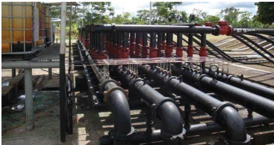
Figura 23. Manifold de Producción de la Estación Shushuqui
