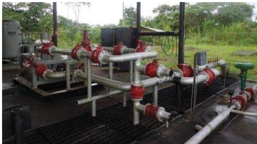
Figura 18. Bombas de refuerzo del sistema de Power Oil
