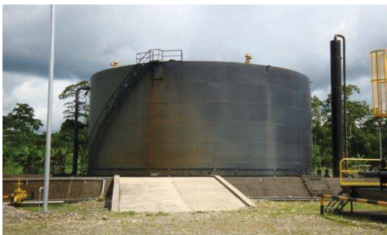
Figura 17. Tanque de reposo de la estación Shushuqui
