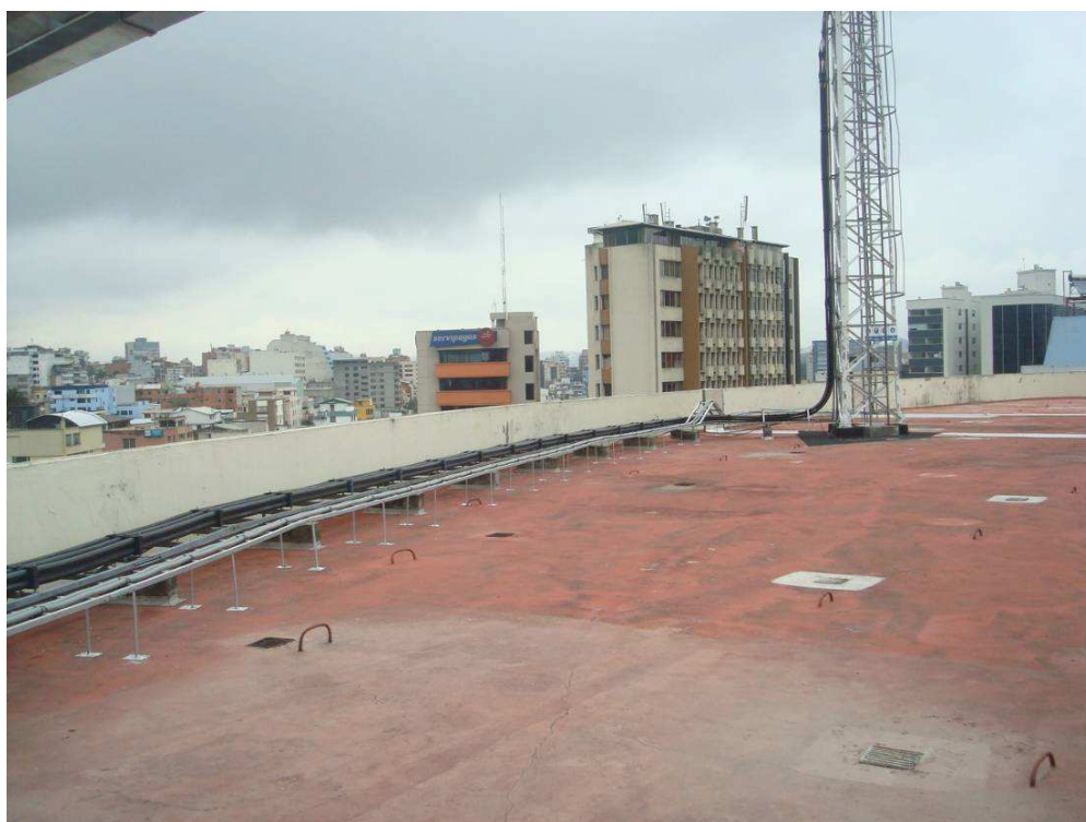
Figura 14. Se observan las escalerillas horizontales que sirven como soporte para colocar el cable que sube por la torre.
