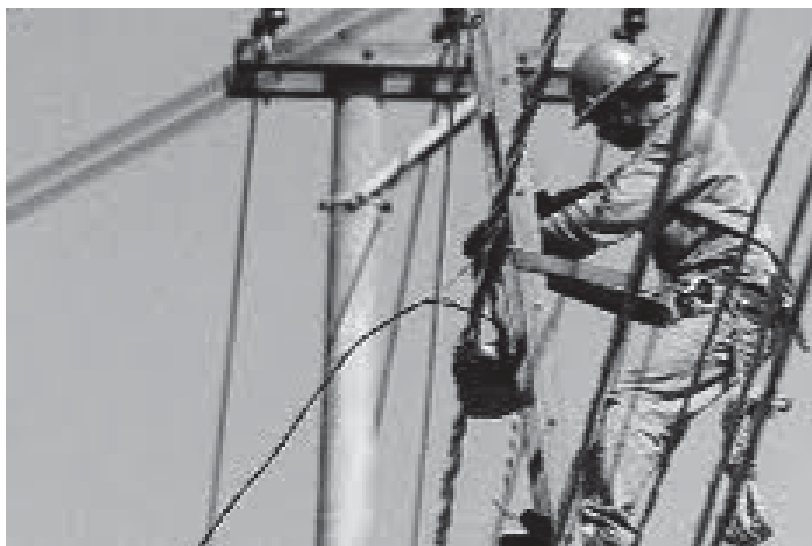
Figura 45. Prohibición de trabajo en postes
