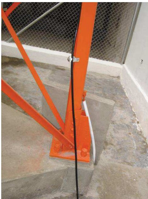
Figura 33. Colocación de jumper para aterrizar todas las estructuras. Adaptado de: La Organización Ecapro, 2011.
