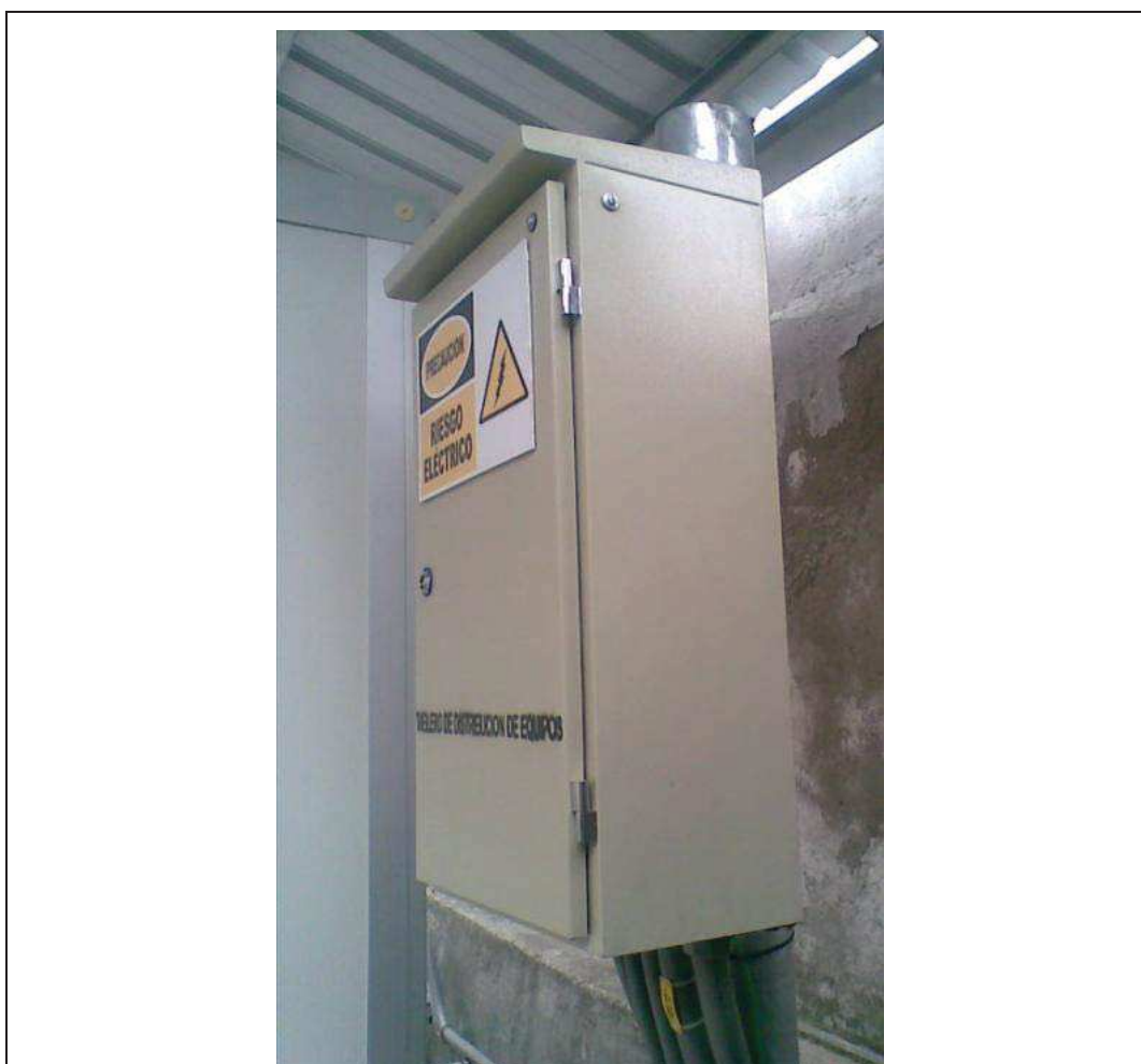
Figura 11. Instalación de cables eléctricos: se observa los cables conectados al tablero en la parte inferior del mismo.
