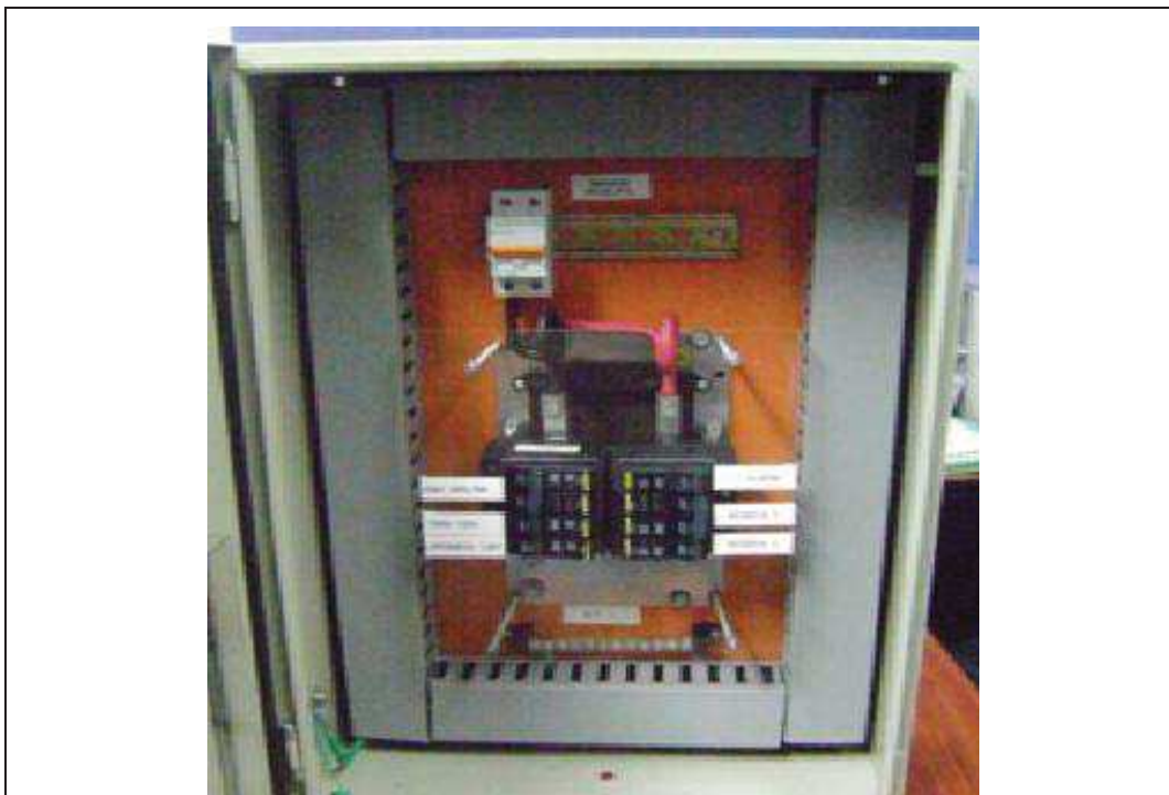
Figura 12. Montaje del tablero se lo denomina a la estructura la parte eléctrica ya viene instalada desde la planta de producción. Adaptado de: La Organización Ecapro, 2011.
