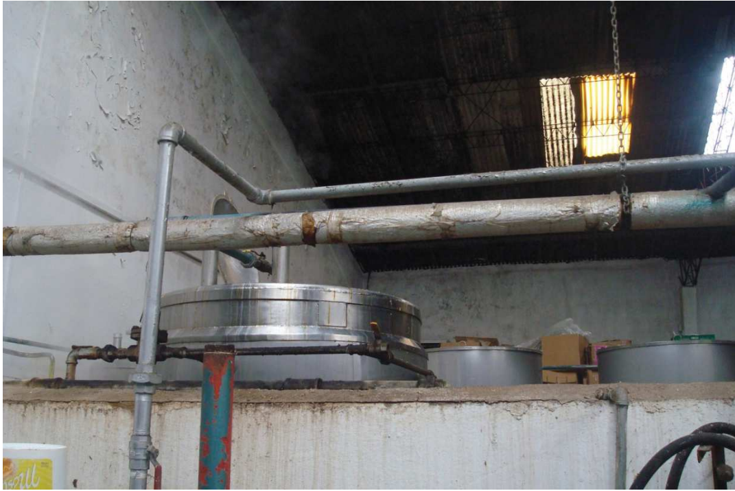
Tuberías de vapor de marmitas
