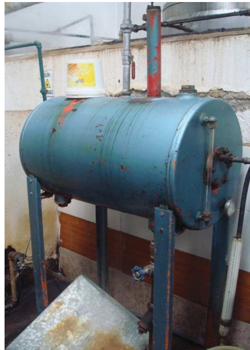
Área de caldero
