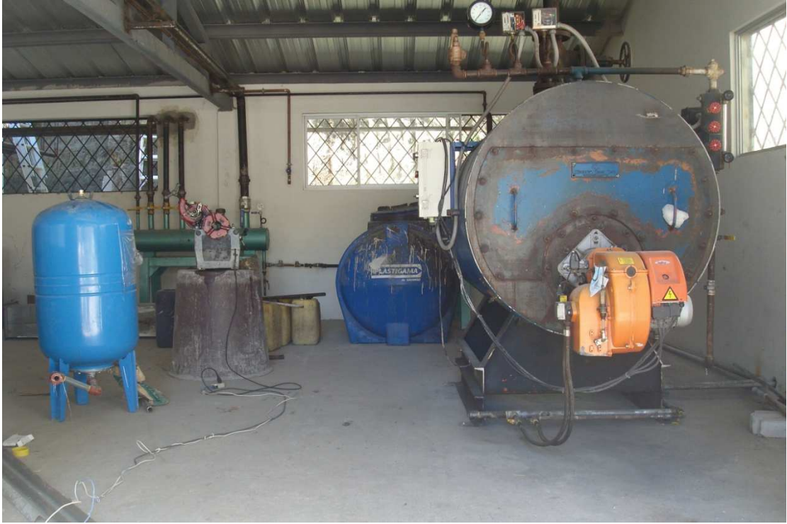
Área de caldero
