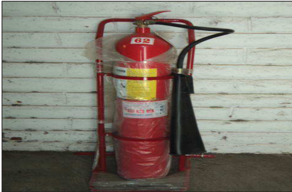
Figura 11. Extintor 25 Lbs de CO2
