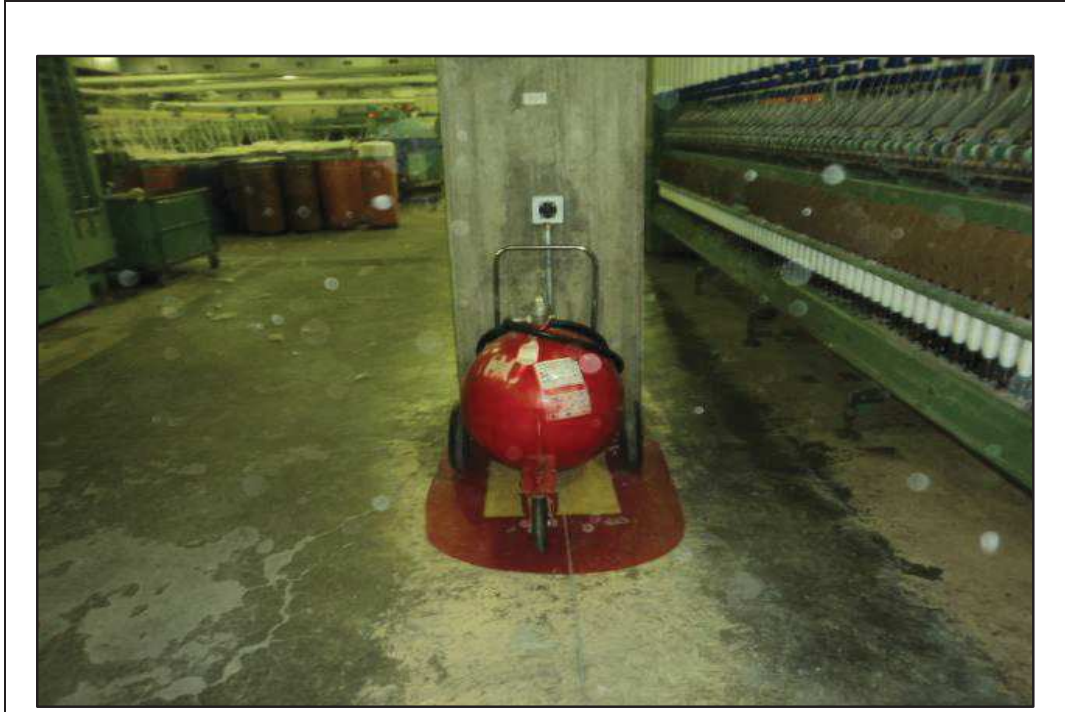
Figura 9. Extintor 150 Lbs PQS tipo satélite
