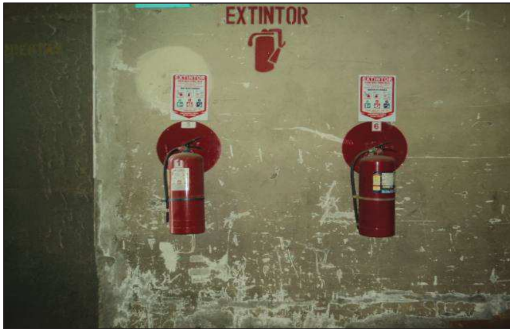
Figura 7. Extintores 20 Lbs PQS
