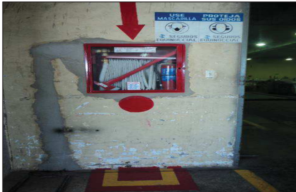
Figura 5. Boca de incendios
