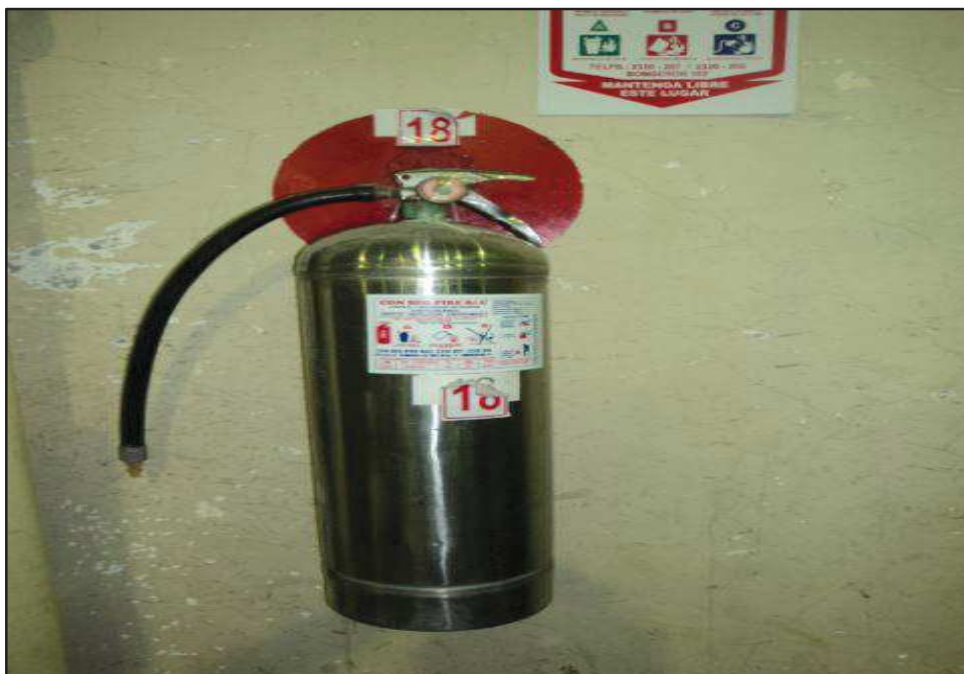
Figura 6. Extintor 2.5 Glns Agua
