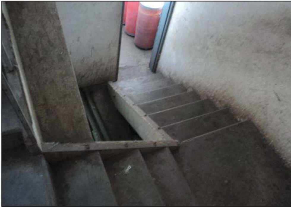
Figura 46. Escalera sin pasamanos
