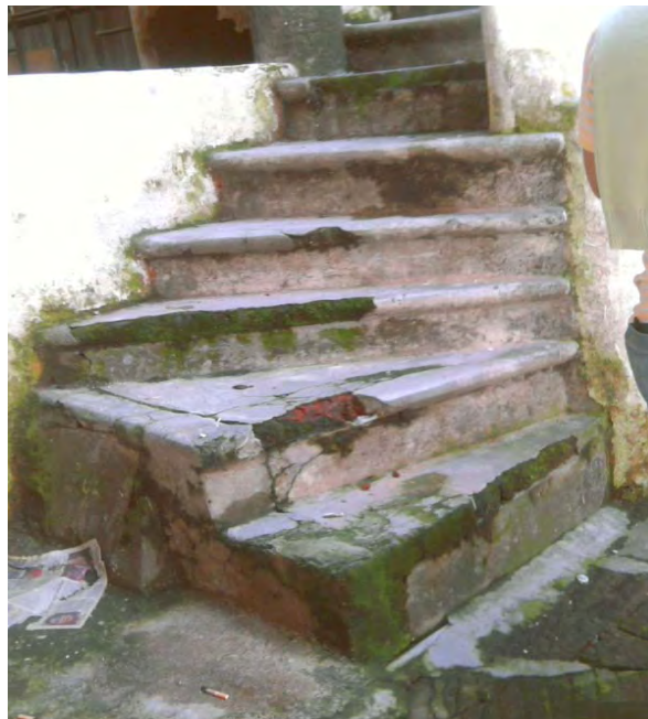
Fotografía 14.12 Estado de las gradas para ir al bloque # 2
