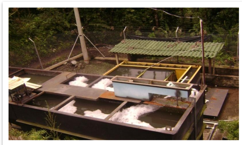
Foto N° 4.5. Planta de Tratamiento de Aguas Residuales
