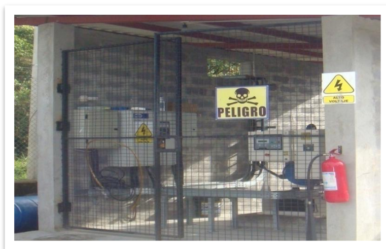
Foto N o 4.4. Generador Eléctrico
