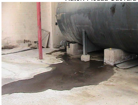
Foto 2.13 Suelo presenta derrame de combustible Autor: Piedad Guevara
