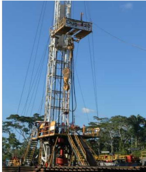
Figura 5. Torre de taladro para un proceso de reacondicionamiento de pozos (Workover)
