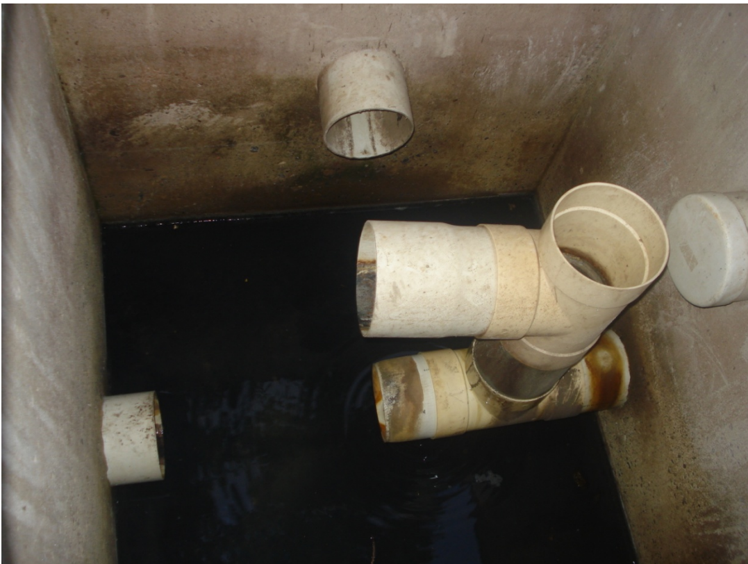
Anexo 12. Accesorio para manipular el nivel de agua en el humedal artificial.
