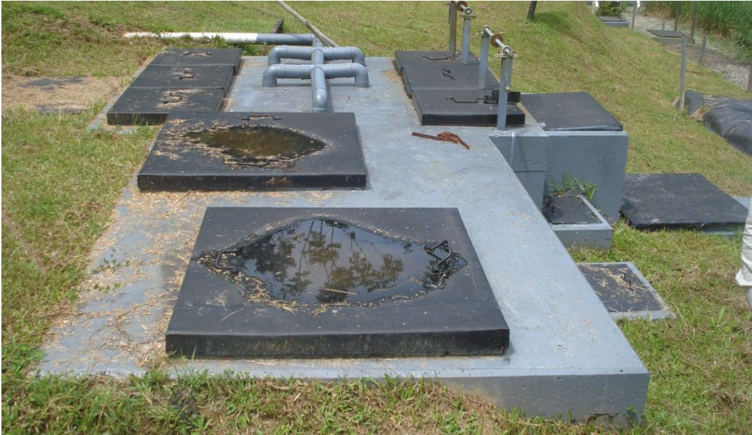
Anexo 11. Condición actual del tanque sedimentador o tanque Imhoff.
