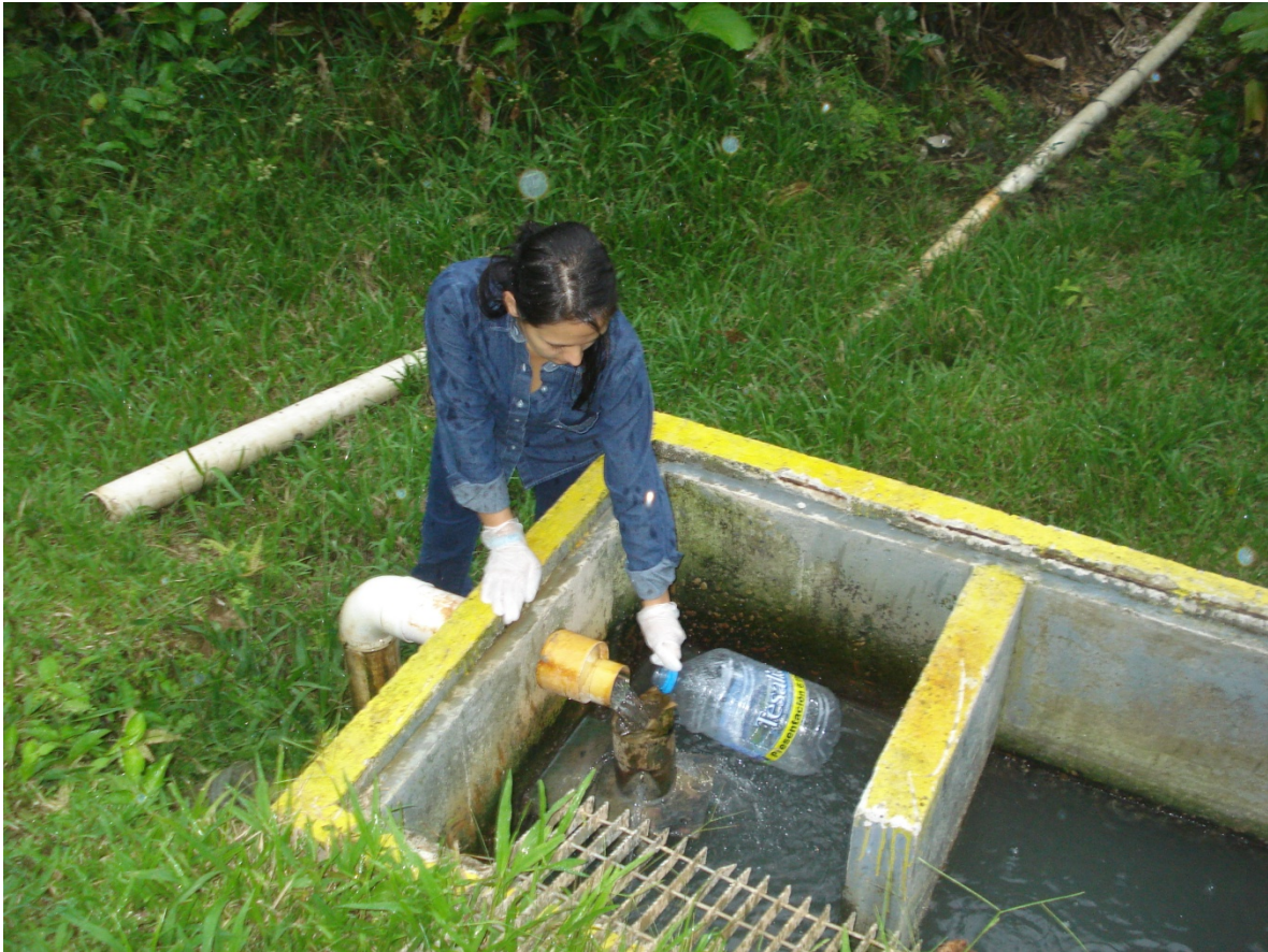
Anexo 13. Fotografía del tanque de cloración como proceso final del tratamiento de aguas en el campamento AMO1
