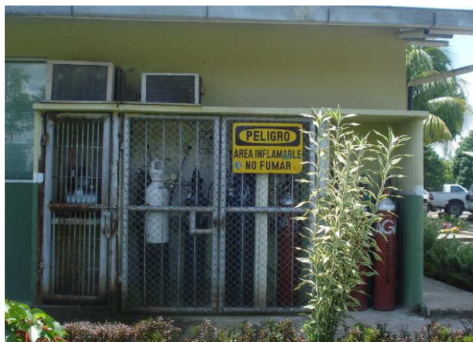
Figura 4.9 Tanques de Gas Helio
