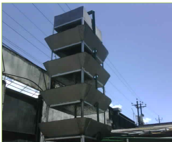
Ilustración 3-32 Sistema de Tratamiento de Agua Primario de VYM S.A.
