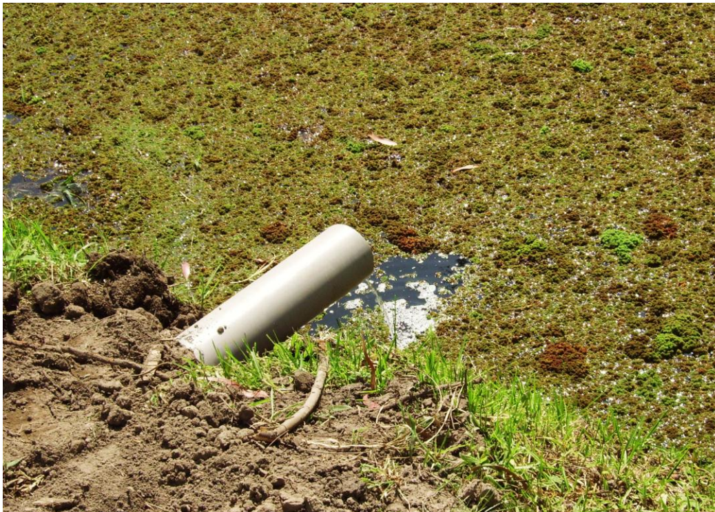
Foto 25: Salida del sistema de filtración al reservorio
