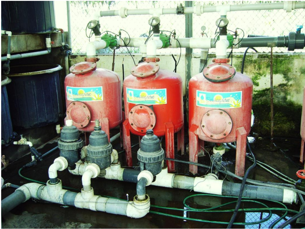
Foto 14: Filtros de arena y dosificadores, área de bombeo.
