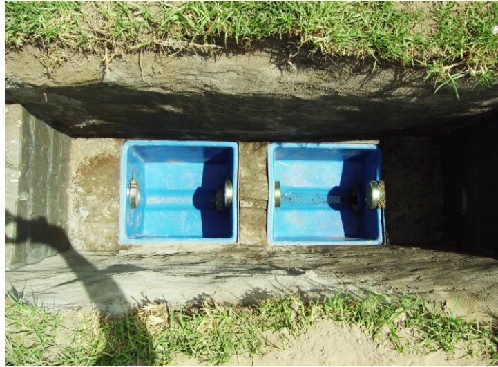
Foto 31: Dispositivos de retención en el sistema de filtración.
