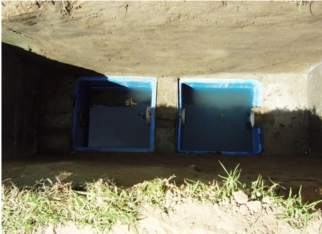
Foto 29: Flujo de agua por los tanques
