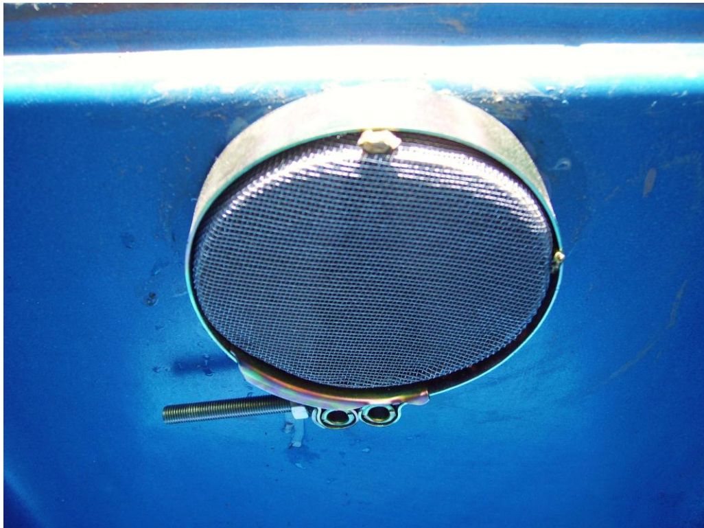
Foto 30: Malla de retención acoplada a la tubería de entrada al filtro.
