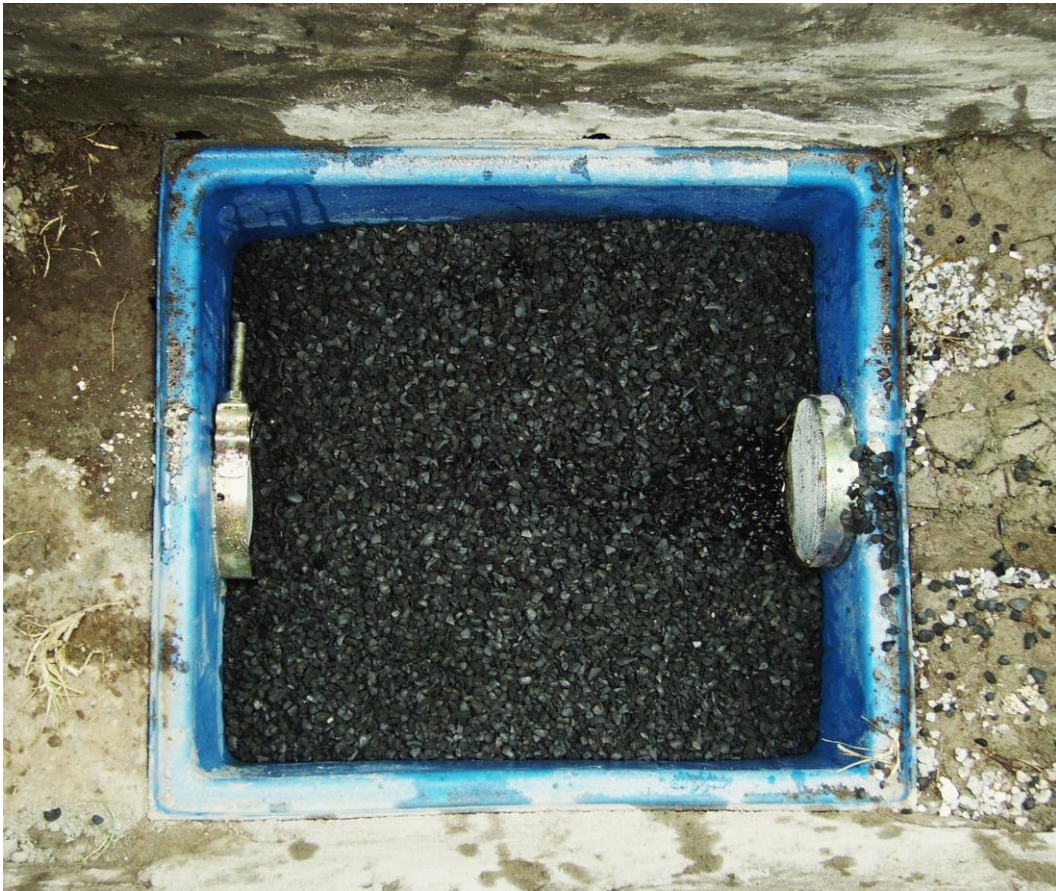
Foto 34: Filtro de carbón activado, segunda fase
