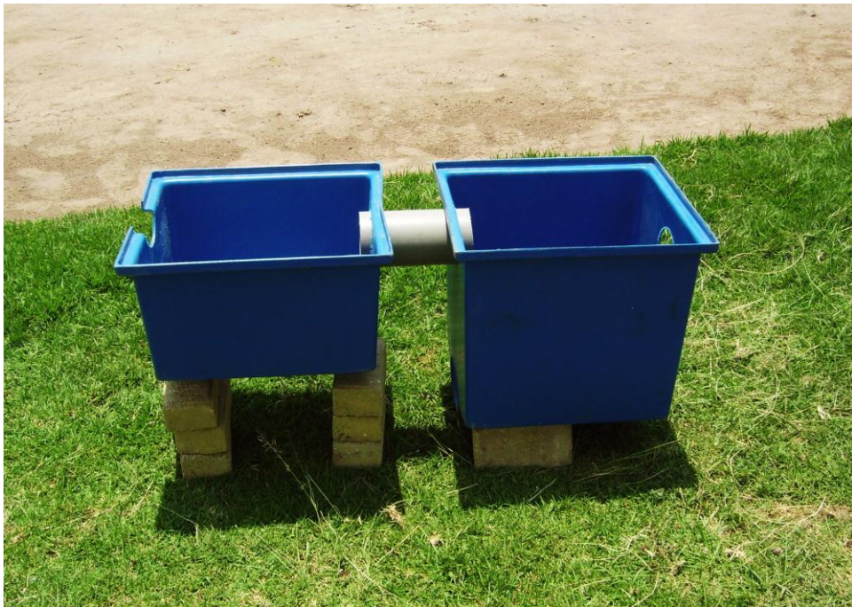
Foto 23: Disposición de tanques para filtración.
