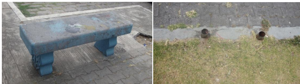
Figura 28. Bancas destruidas y tubos inservibles.
