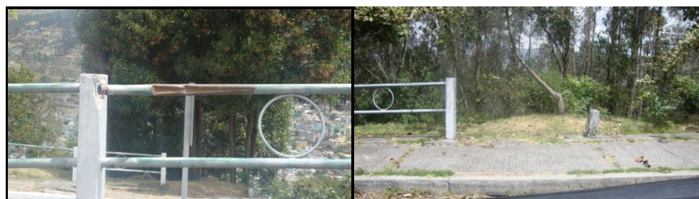
Figura 29. Barandales destruidos e incompletos.
