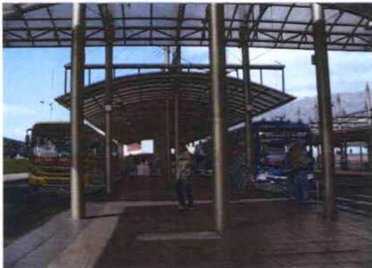
Completa Falta de señalética y mobiliario Andén mixto (Estación La Ofelia)
