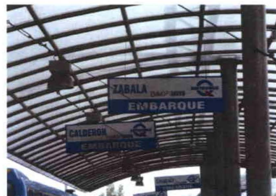
Señalética que no brinda información de la ruta a seguir. (Corredor Central Norte)
