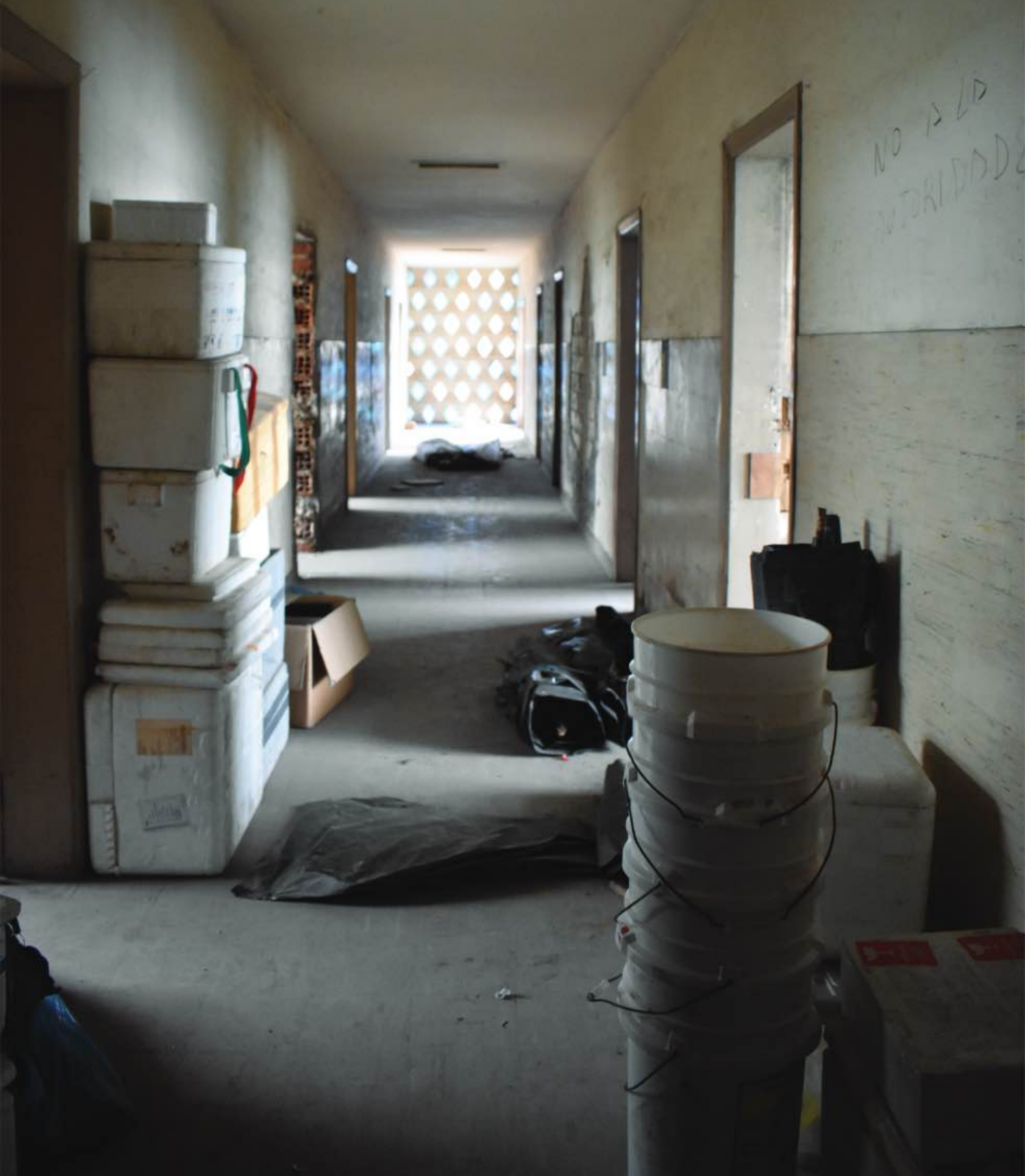
Fig.45 Estado actual del edificio de la Antigua Residencia Universitaria - área de habitaciones en abandono cuarto piso alto Fuente. Propia
