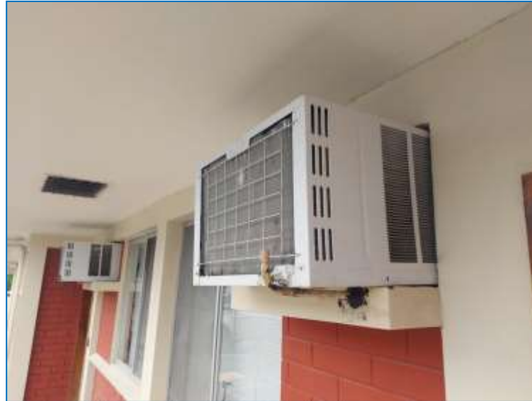
Ilustración 8.- Equipo de climatización – Campamento Auca Central
