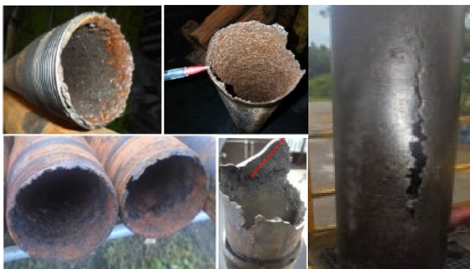
Ilustración 1. Tubería con corrosión recuperada de los pozos del campo Shushufindi – Aguarico
