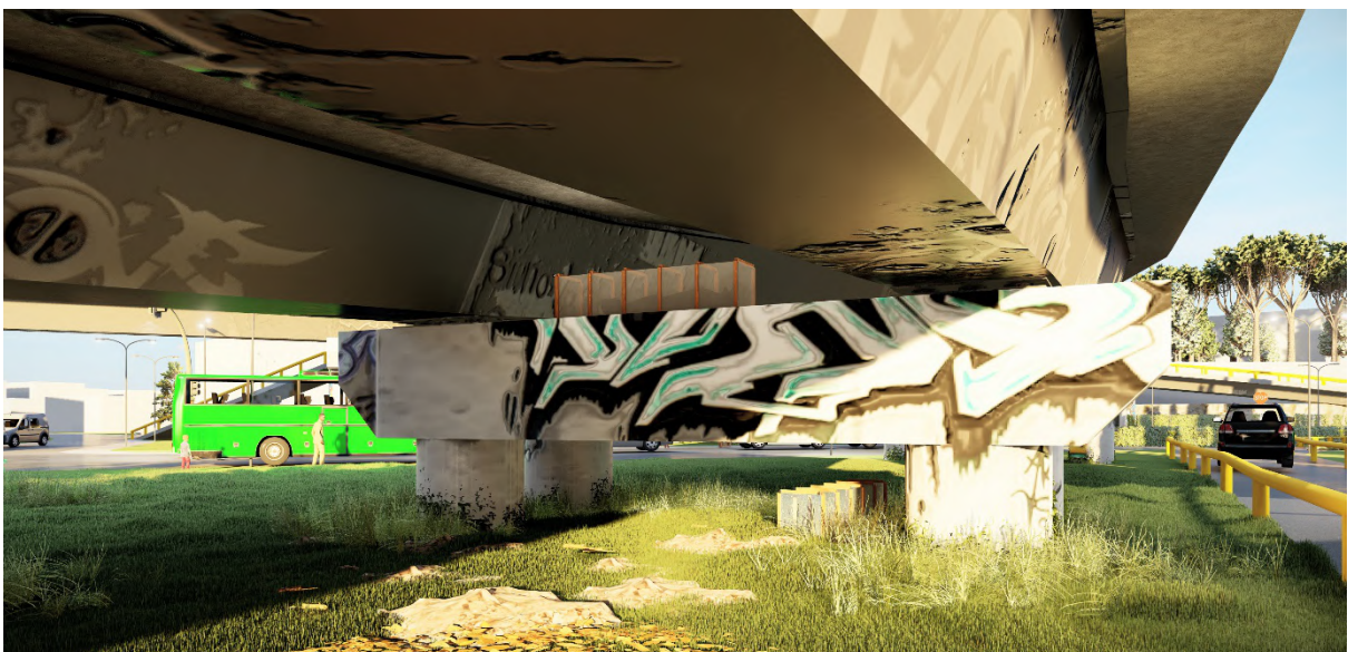
Figura 135. Vista dispositivo parásito en puente. Elaboración autor.
