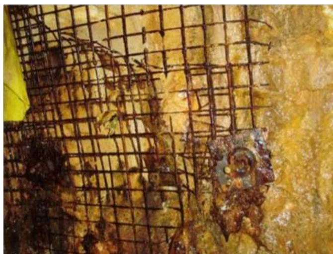
Figura 28: Deterioro de revestimiento por aguas ácidas
