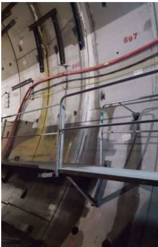
Figura 31: Filtraciones de dovelas en túnel Metro de Quito
