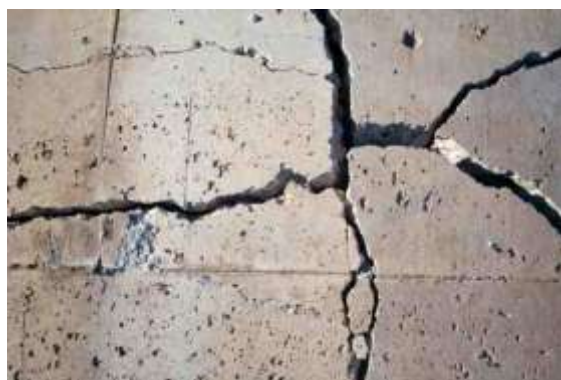
Figura 30: Detalle de grietas en hormigón
