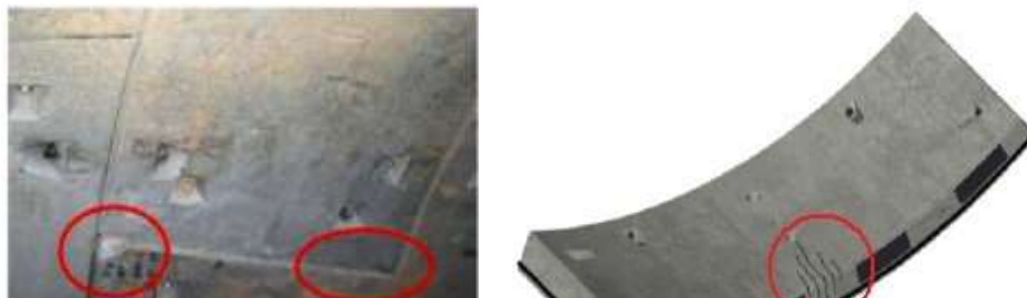
Figura 65: Fisura de dovelas producidas por mucha presión
