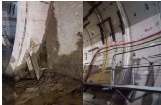
Figura 75: Evidencias de Filtraciones Metro de Quito
