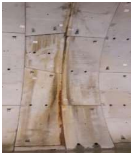
Figura 34: Decoloración de dovelas en túnel del Metro de Quito
