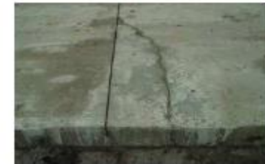
Imagen 10: Fisura pasiva Fuente: www.cambiarata.com
