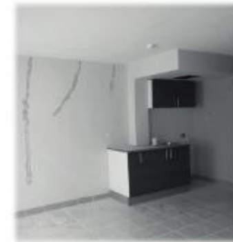
Fotografía 2: Vivienda-sistema constructivo de mampostería de bloque y hormigón fundido, fisuras existentes área de cocina Fuente: Autoría propia
