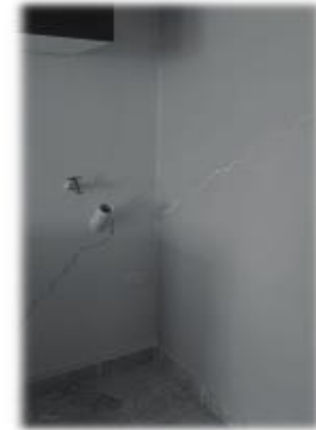
Fotografía 1: Vivienda-sistema constructivo de mampostería de bloque y hormigón fundido, fisuras existentes área de lavado Fuente: Autoría propia
