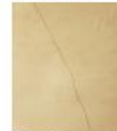
Fotografía 4: Fisura en pared Fuente: Autoría propia
