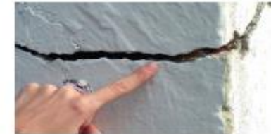
Imagen 9: Fisura activa Fuente: Shutterstock
