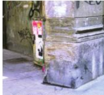
Imagen 6. Erosión mecánica en cemento estructural debido a golpes o rozaduras Fuente: Foto, 2020
