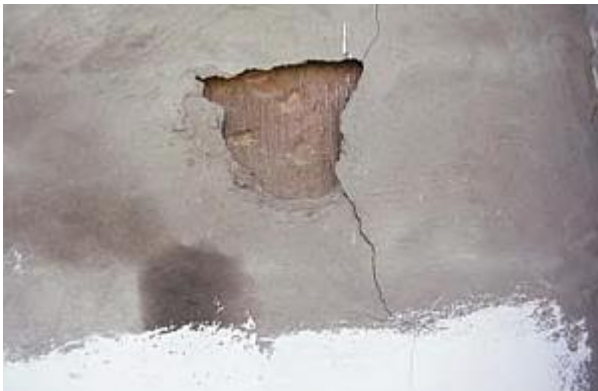
Figura 3. Desprendimiento Tomada de (Construmática, 2020)
