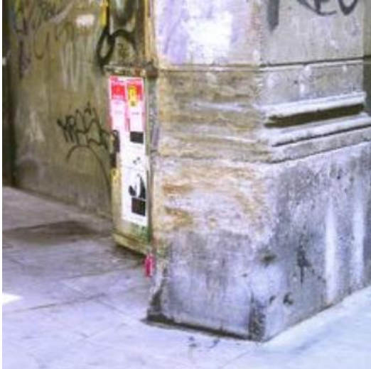
Figura 4. Erosiones mecánicas Tomada de (Armijos, 2018)
