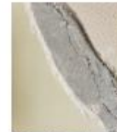
Fotografía 5: Fisura despejada Fuente: Autoría propia
