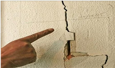
Figura 15. Grieta Tomada de (Inmoanálisis, 2020)
