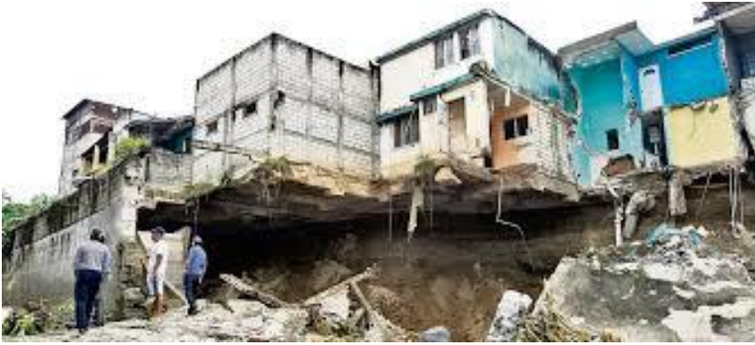
Figura 21. Sistema constructivo inadecuado Tomada de (Libre, 2019)
