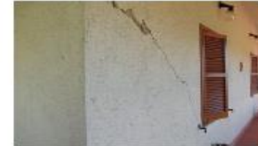
Imagen 7. Grietas en muro Fuente: www.grietas.com
