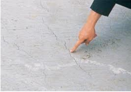
Figura 10. Contracción plástica del hormigón Tomada de (Armijos, 2018)
