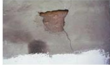
Imagen 5. Desprendimiento de artículo en pared Fuente: www.construmatica.com
