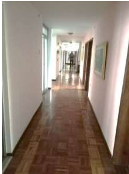
Figura 67. Estado actual de paredes interiores.
