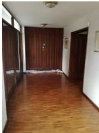
Figura 66. Estado actual piso interior.
