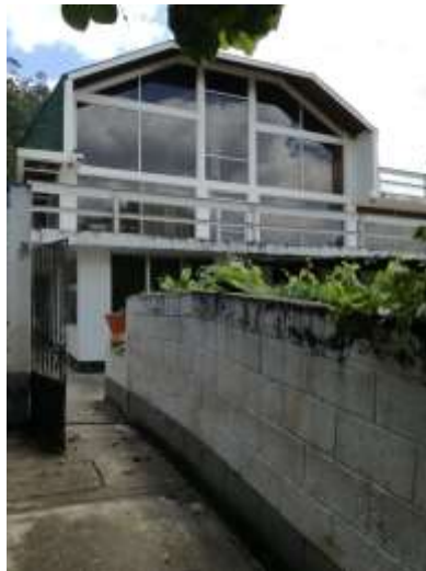
Figura 68. Estado actual de paredes exteriores.
