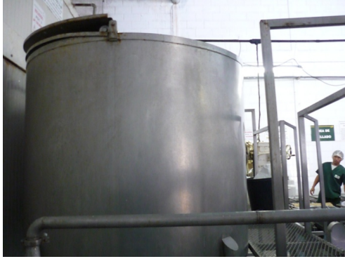
Tanque de vapor
