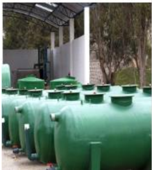
Figura 162. Soluciones en tratamiento de agua. Tomado de AquaRock.
