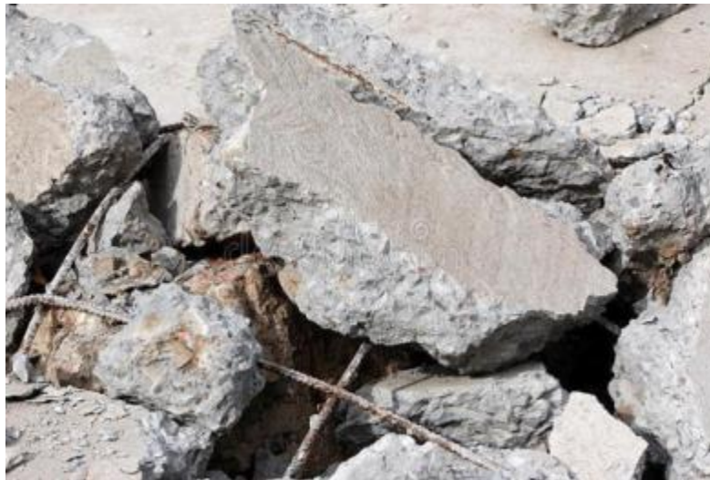
Figura 2. Residuos de Hormigón.
