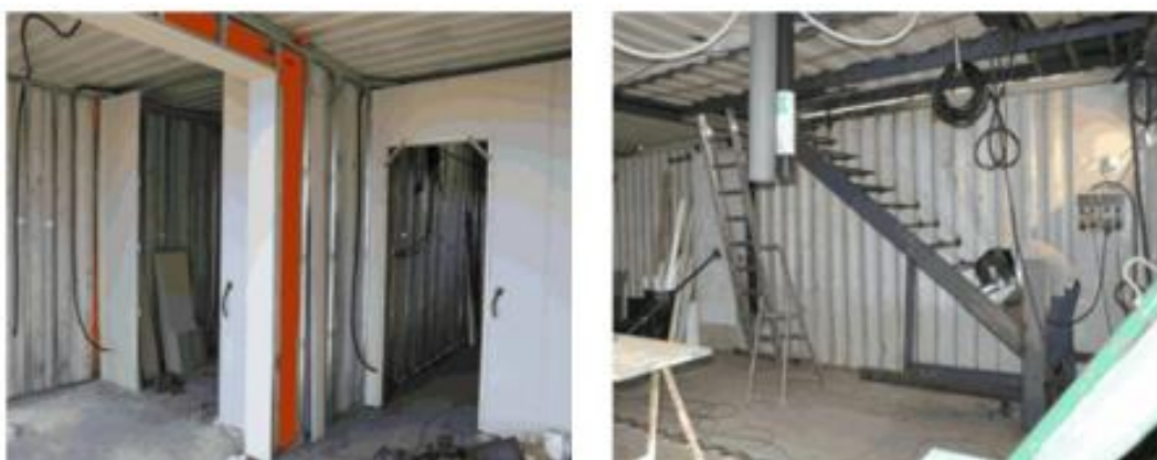
Figura 57. Instalaciones Eléctricas en Vivienda Contenedor.
