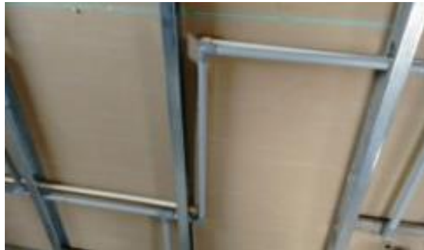
Figura 107: Circuito eléctrico en tubería rígida.
