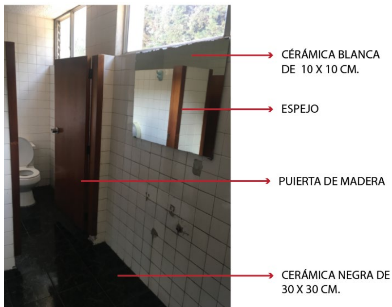
Figura 63. Análisis N°2 de las baterías sanitarias del salón de entretenimiento del Club La Campiña
