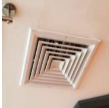
Salida de aire acondicionado.
