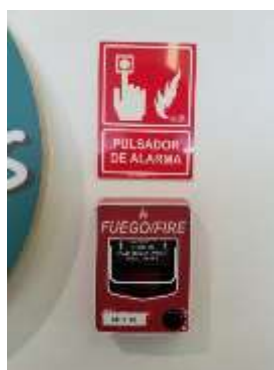
Alarma de incendio
