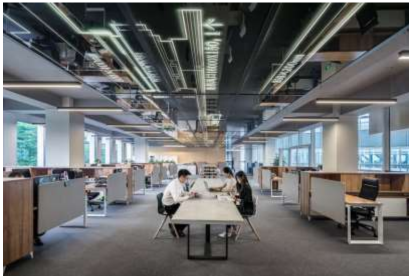
Figura 57. Iluminación lineal en oficinas.
