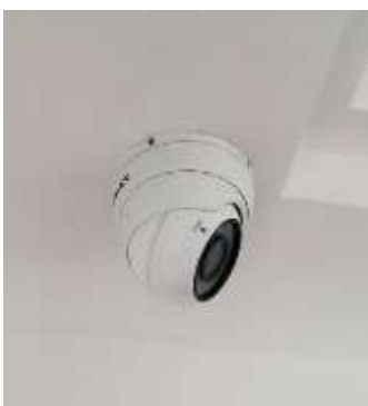
Cámara de seguridad
