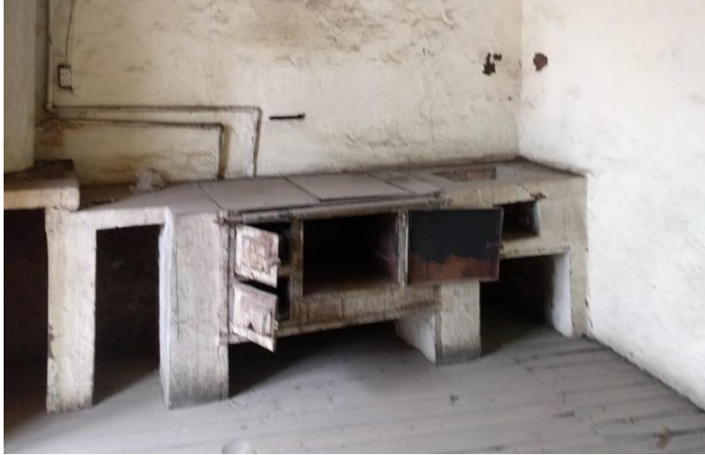
Figura 45. Mobiliario Fijo en mal estado
