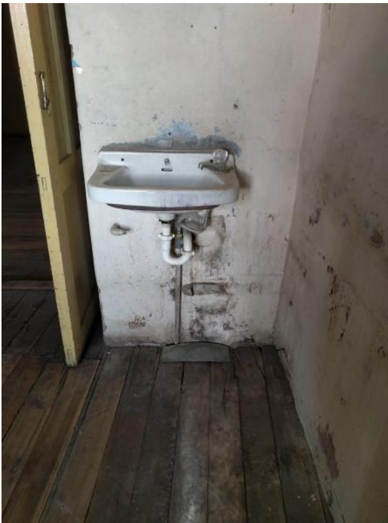
Figura 48. Instalaciones sanitarias en mal estado.
