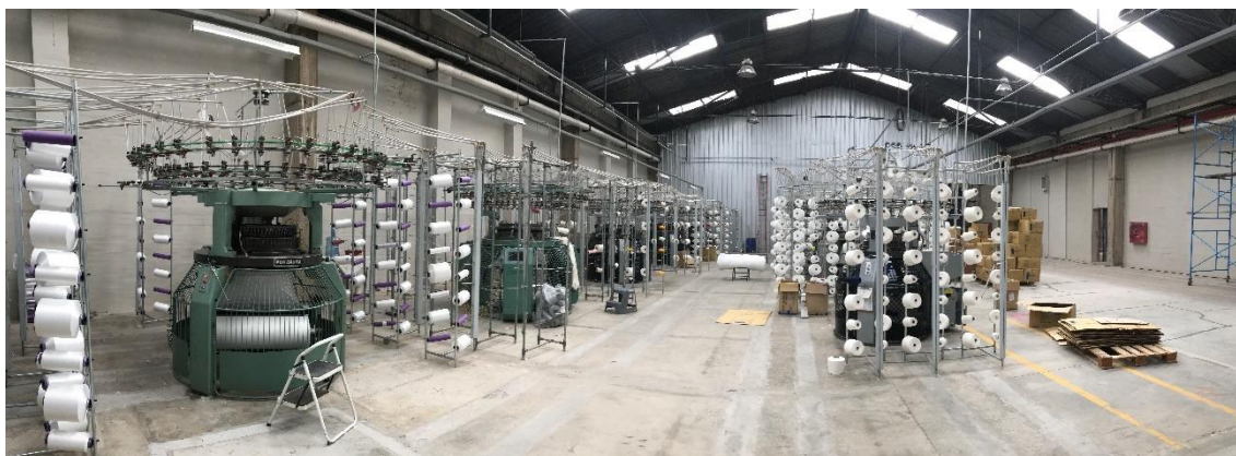
Figura 8. Distribución de máquinas circulares.
