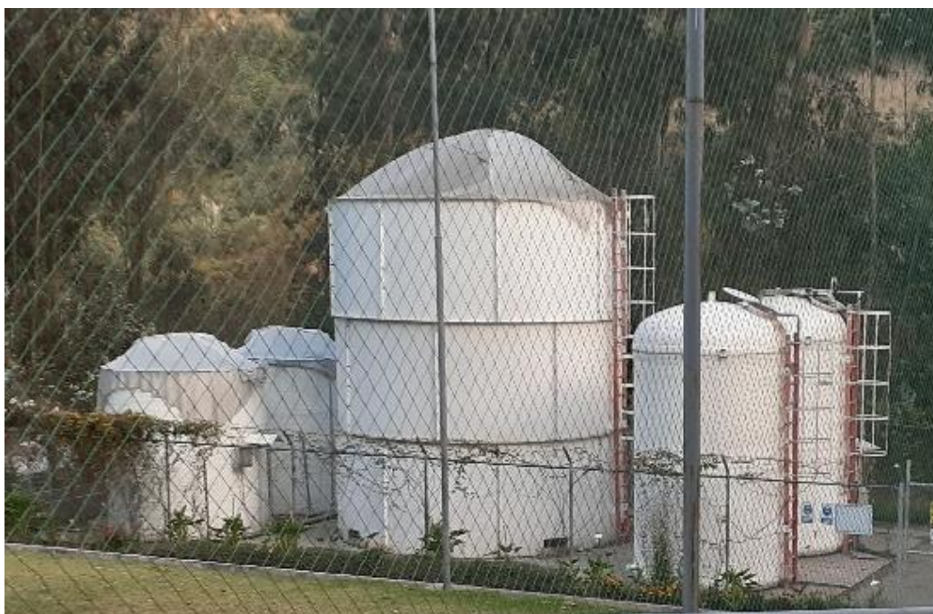
Figura 14. Planta de tratamiento de aguas residuales.
