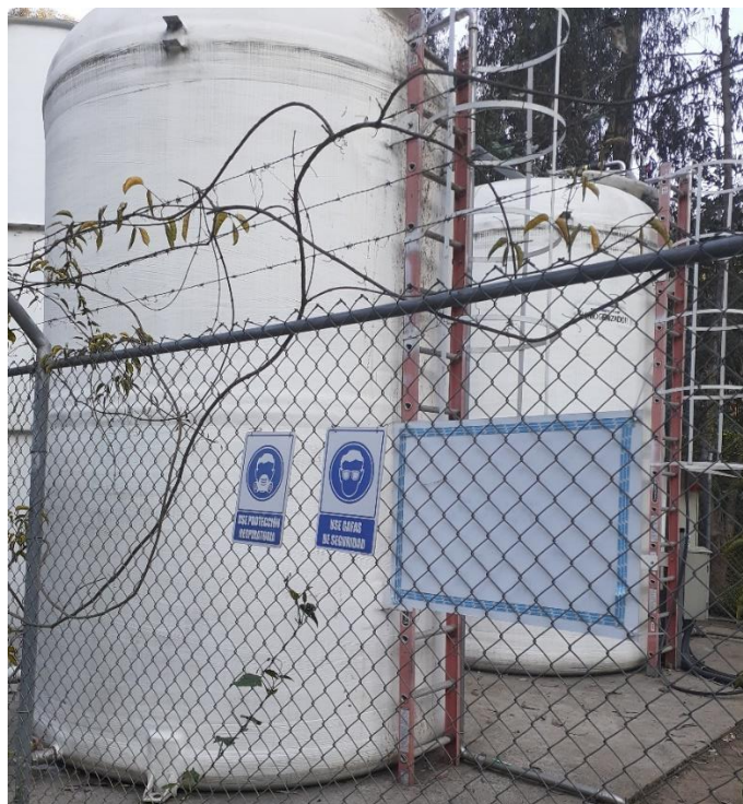
Figura 17. Tanques Homogenizador 2 de la planta de tratamiento de agua.
