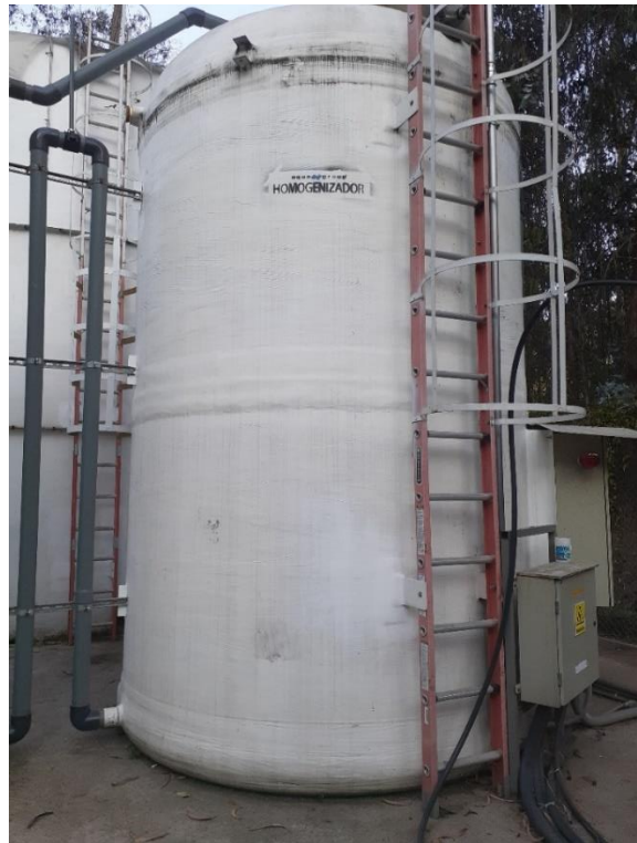
Figura 16. Tanque Homogenizador 1 de la planta de tratamiento de agua.
