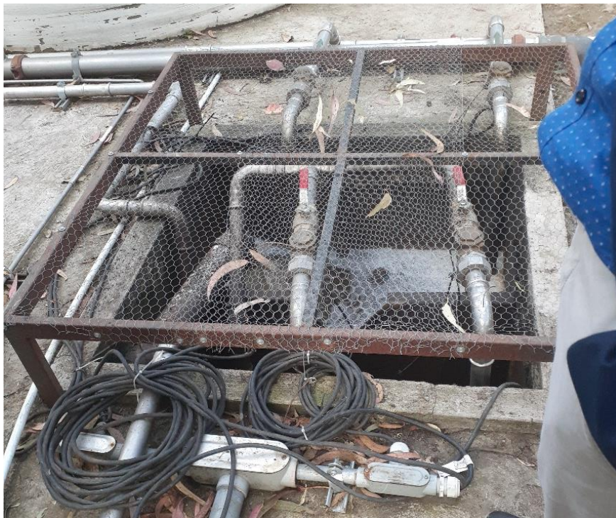
Figura 19. Válvulas de control de agua
