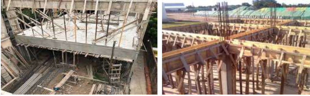
Figura 8 Vigas perdidas Tomado de: (Nociones sobre el hormigón armado, s.f.)
